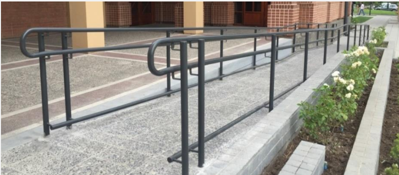
Foto 51: Rampa con pasamanos a doble altura. Ambos pasamanos deben ser continuos, de manera que el deslizamiento de la mano no se interrumpa en todo el trayecto.
