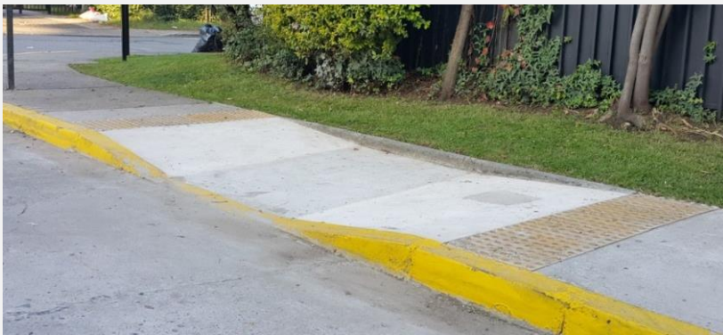
Foto 10: Cruce peatonal rebajado en todo su ancho hasta igualar la altura con la calzada
