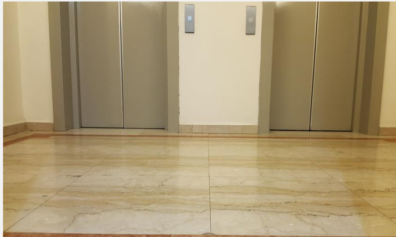
Foto 55: Área frente a un ascensor que permite girar en 360° a una silla de ruedas.
