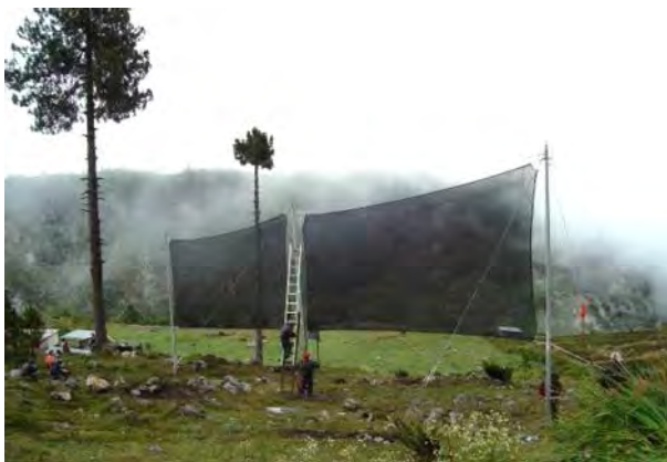
Figura 4. Estructuras “Atrapanieblas” instalados en Tojquia, Guatemala, a 3.300 m.s.n.m. (Año 2007). Proyecto FogQuest: sustainable and water solutions.
