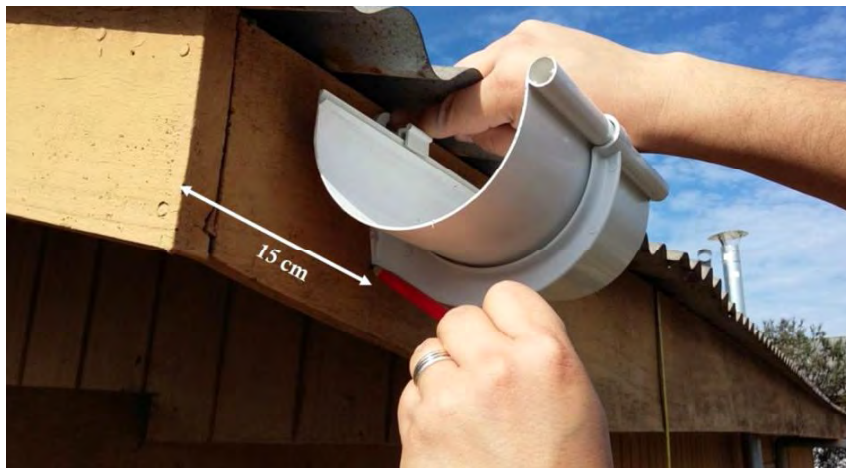
Figura 1. Ubicación del primer gancho de sujeción para dar inclinación a la canaleta.
