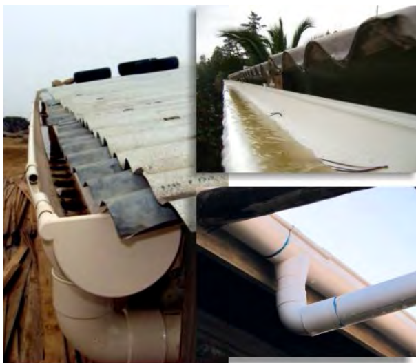
Figura 12. Sistemas de captación de aguas lluvias utilizando techos de las casas, además de canaletas y tubos de polietileno para la conducción hacia sistemas de acumulación.
