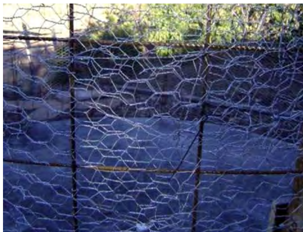
Figura 19. Detalle del recubrimiento de la malla de gallinero.
