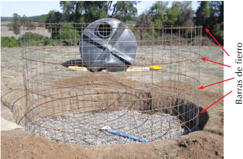
Figura 16. Formación del cilindro de la cisterna, utilizando una estructura con hierro estriado diámetro 8 mm.
