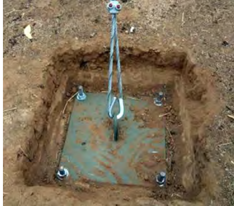
Figura 10. Anclaje metálico, apernado a la roca, utilizado para sostener la estructura "Atrapanieblas". La Aguada, Comuna de Navidad, Región de O'Higgins.
