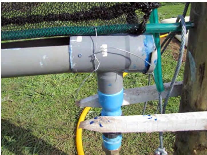
Figura 28. Instalación del sistema de conexión a canaleta captadora de aguas y al estanque de acumulación.
