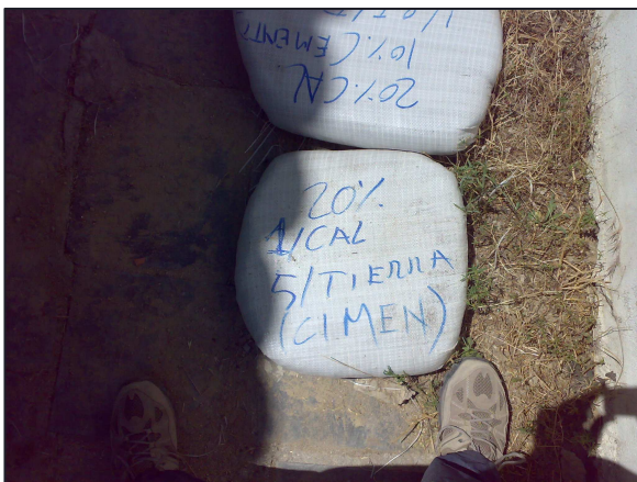
Foto2: Pruebas en el saco (un tramo de 1,5 m aprox). Doblamos los extremos para llenarlo de mezcla y compactamos.
