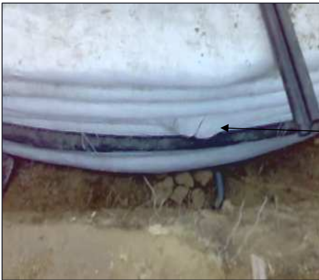
Foto 17. Fallo por no tener en cuenta el ángulo del eje horizontal
