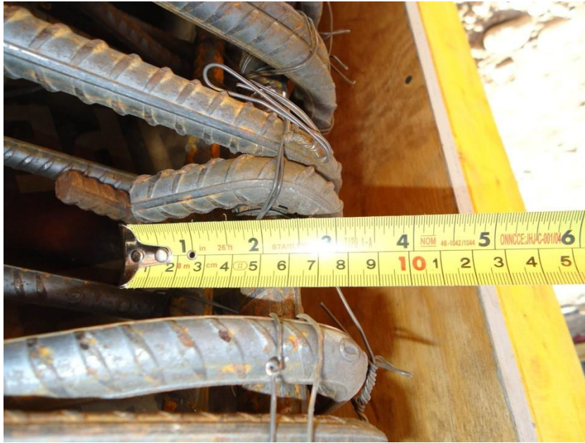
Figura N° 14: : Producto no conforme 4
