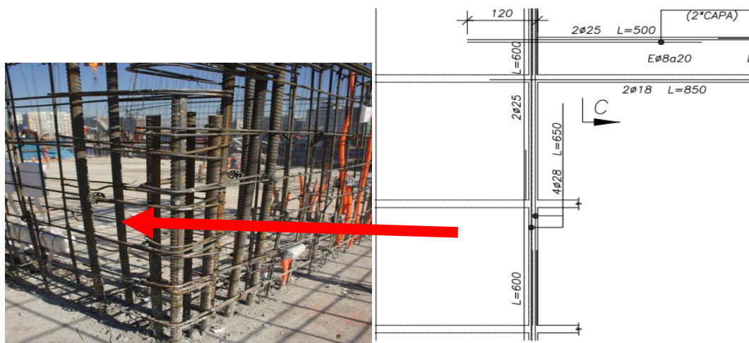
Figura N° 11: Producto no conforme 1
