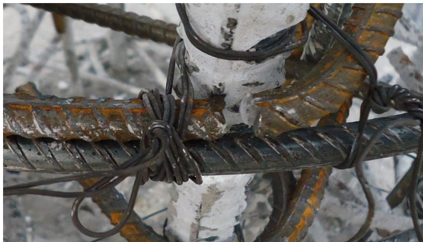
Figura N° 13: : Producto no conforme 3
