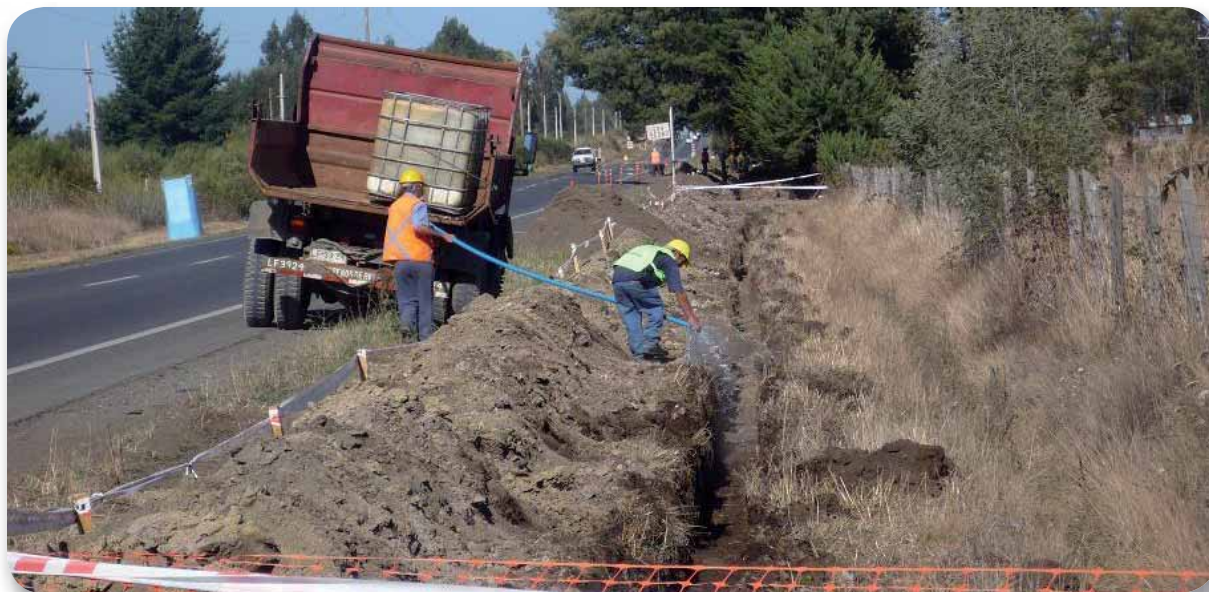
Instalación del Servicio de Agua Potable Rural Trihueche. Nueva Imperial, Región de La Araucanía.
