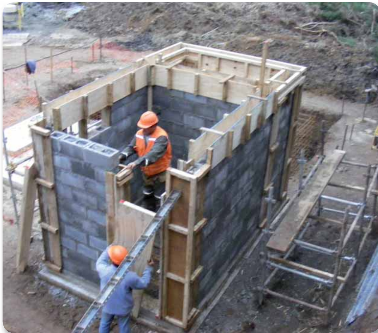
Construcción de Sistema de Agua Potable Rural en Isla de Rey. Corral, Región de Los Ríos.
