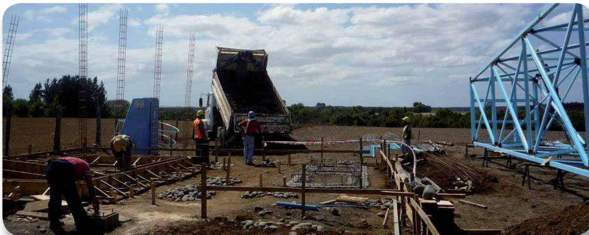
Instalación del Servicio de Agua Potable Rural Trihueche. Nueva Imperial, Región de La Araucanía.
