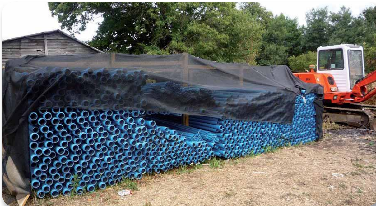
Instalación del Servicio de Agua Potable Rural Trihueche. Nueva Imperial, Región de La Araucanía.
