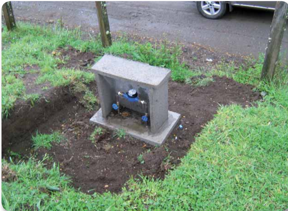
Instalación del Servicio de Agua Potable Rural Putemun. Castro, Región de Los Lagos.
