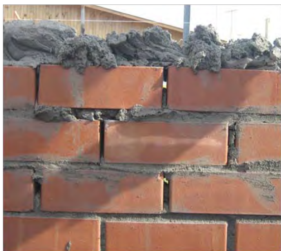
Fig.92. Ejemplo de mala ejecución de llaga vertical.
