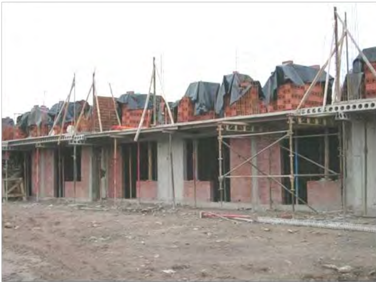
Fig. 54.- Ladrillos tapados con polietileno para evitar el efecto de la lluvia y polvo en suspensión
